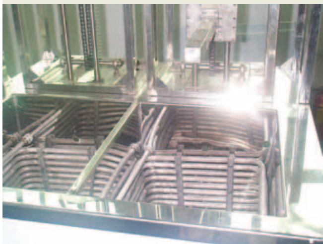
IPA干燥槽体内部
