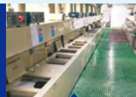
电镀设备-电镀车间一角
